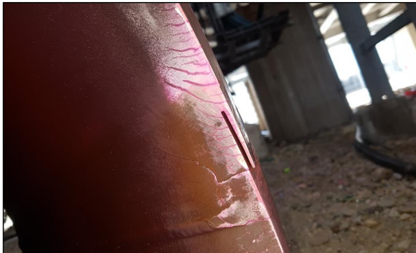
Abbildung 1: PT Anzeigen am heraus getrennten Bogen im Bereich der Rundnaht – in der Bildmitte unten ist die Längsnaht des Bogens erkennbar
