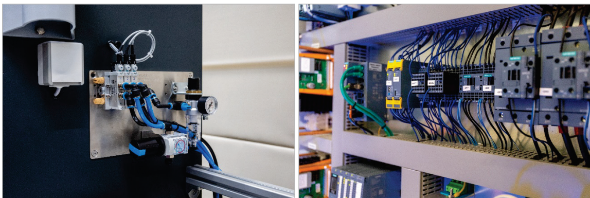
Abb. 3. Pneumatikkomponenten vom renommierten Markenhersteller FESTO (links) und hochwertige Bauteile für die elektrische Steuerung
