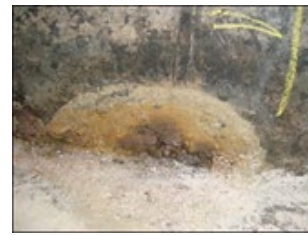
Beispiel eines Kiesnests im Wandfuss einer Stützmauer
